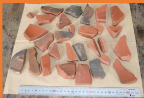
破片状の破損瓦
